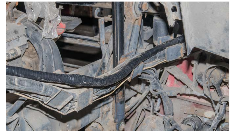
В едином жгуте находятся кабели, идущие к стартеру, генератору, а также провод массы
